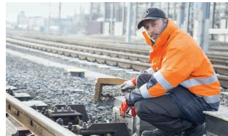
Servicetechniker Thomas Knoll bei der Kontrolle einer Weiche. Mit dabei ist immer ein Kollege, der für die Sicherheit („Zugfreiheit“) sorgt.
