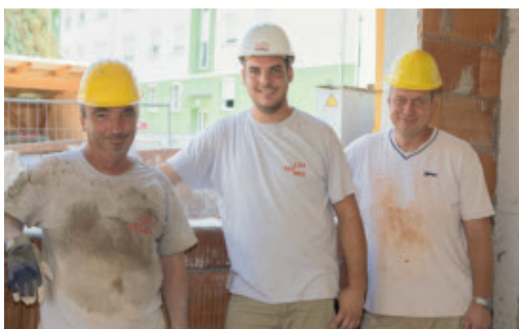
Sandor Gergi, Michael Derler und Andreas Knoll (v. l.) auf einer Baustelle in Weiz. Die Stimmung ist trotz sommerlicher Hitze gut.
